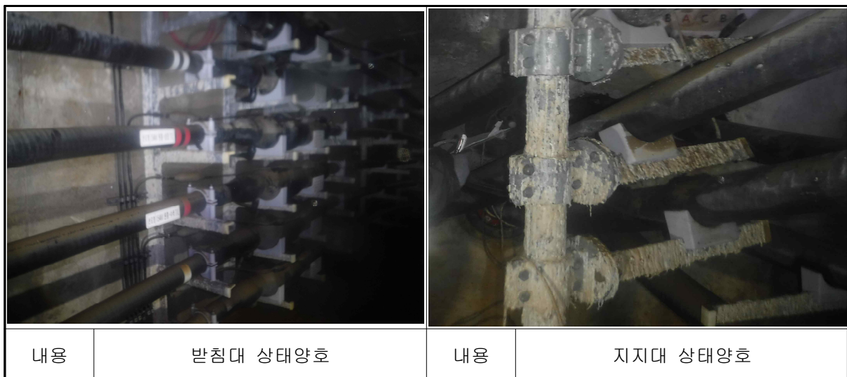
【사진 5.4】 부속 및 부대설비 현황
