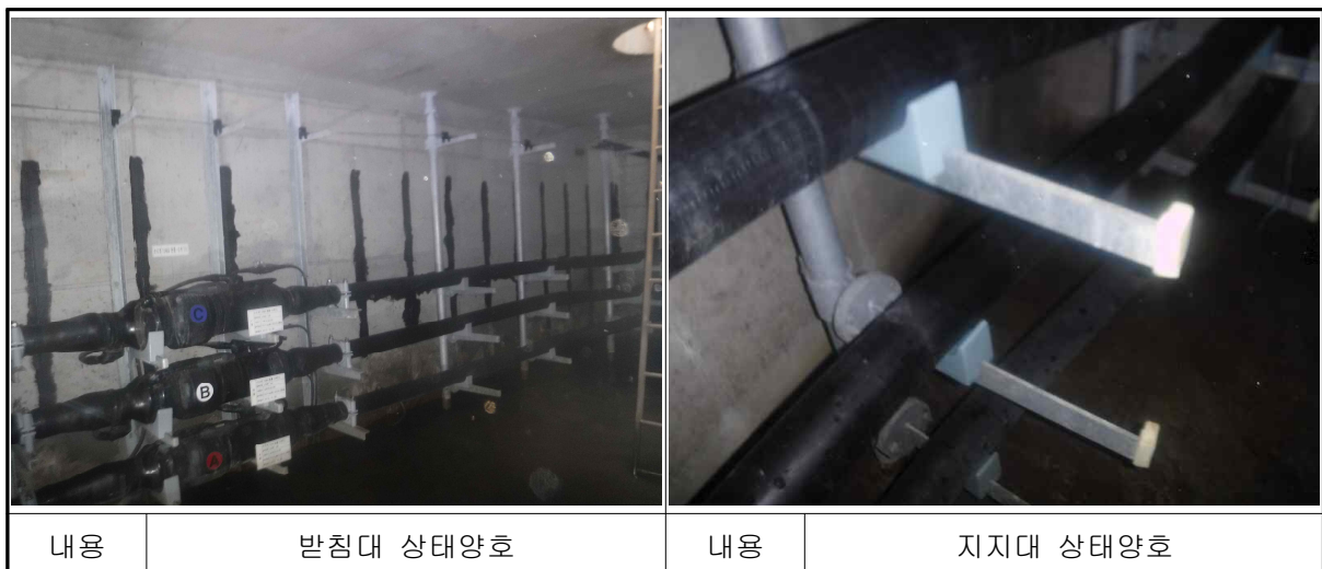
【사진 5.16】 부속 및 부대설비 현황
